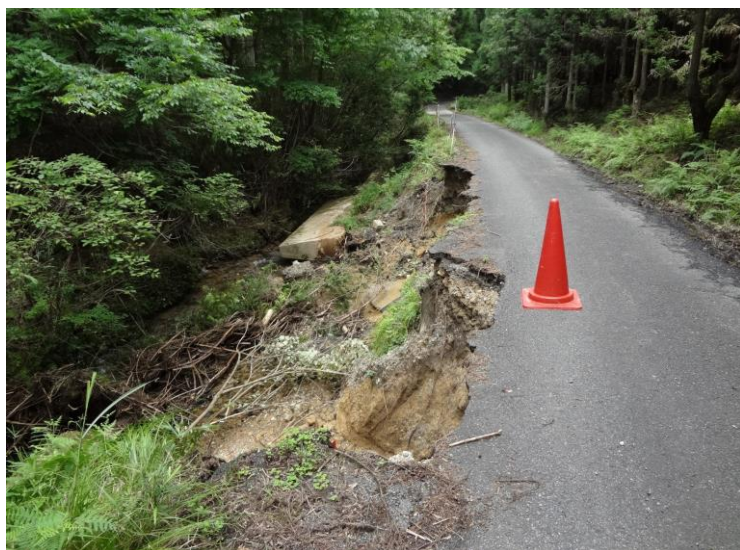
林道中川沢の池線の崩落地
